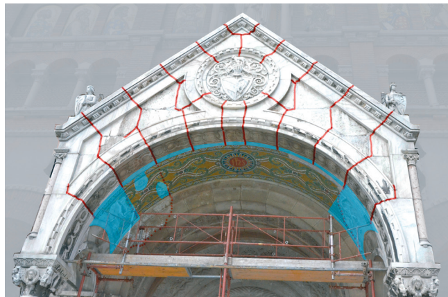
Szeged, dóm főkapu bevezető mozaik, a károsodások és a portikusz köelemek által lejutó nedvesség lehetséges útjainak összefüggései 2015. június 21. ● köelemek fugái ● a mozaikot érintő hiányok, elváltak frontjai és túlteltett köszegély
